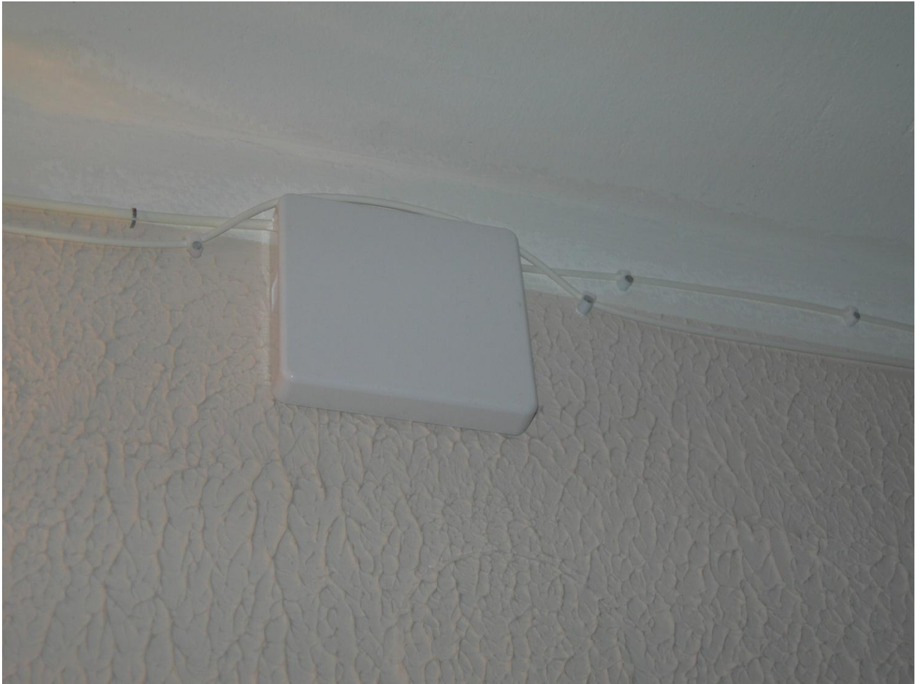
Рисунок 5 – Защита места соединения оптических волокон в подъезде с применением абонентской розетки ШКОН ПА-1.
